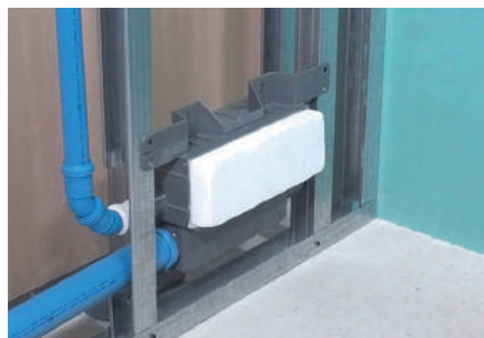
Aplicação em calha técnica
